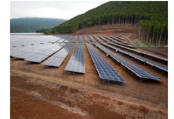
太陽光発電施設
