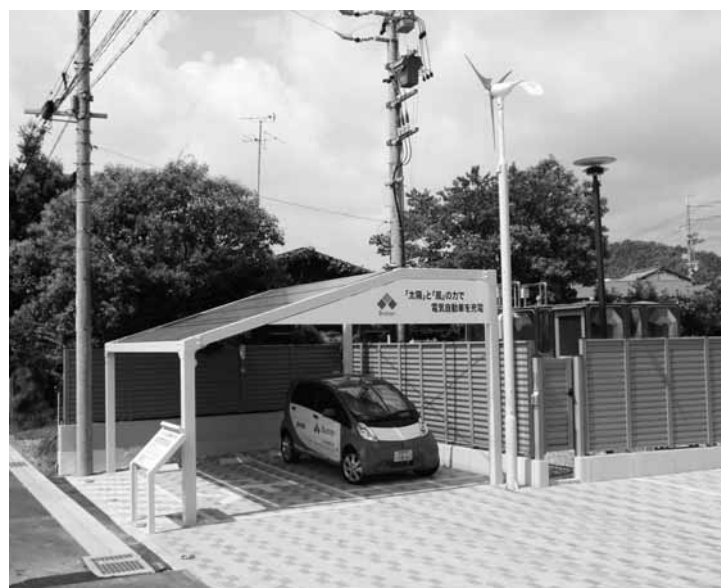
太陽光・風力発電を活用した充電器
