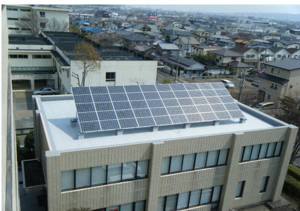
<新エネルギー導入促進事業費助成> 建物に設置された太陽光発電施設
