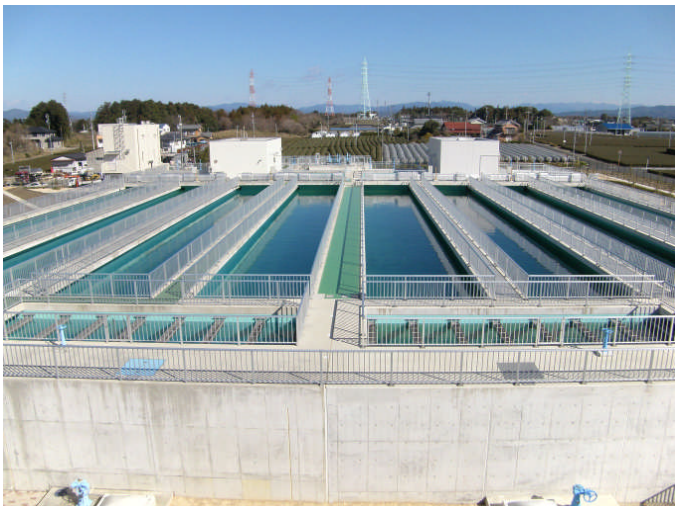
遠州水道 寺谷浄水場
