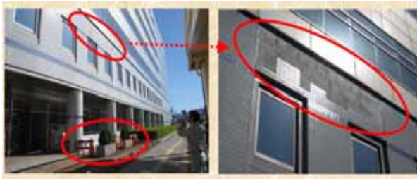
老朽化による外壁の剥離
