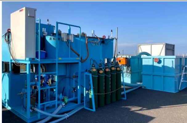
濁水処理設備
