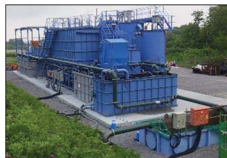
写真 濁水処理設備の例
