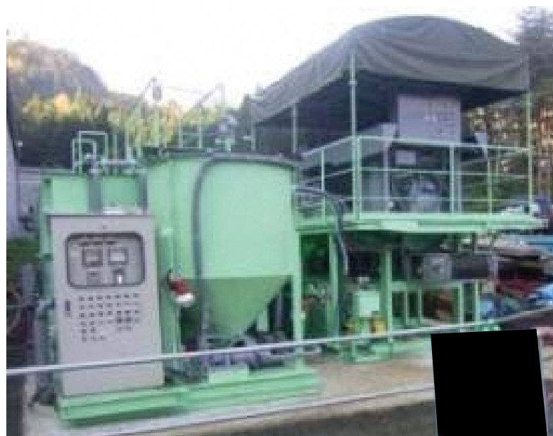
写真 濁水処理設備の例
