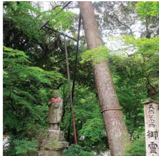
支柱により支えられている樹木 （袋井市：油山寺のスギ）
