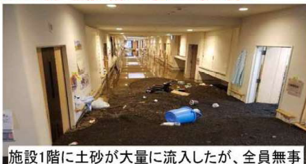
施設1階に土砂が大量に流入したが、全員無事
