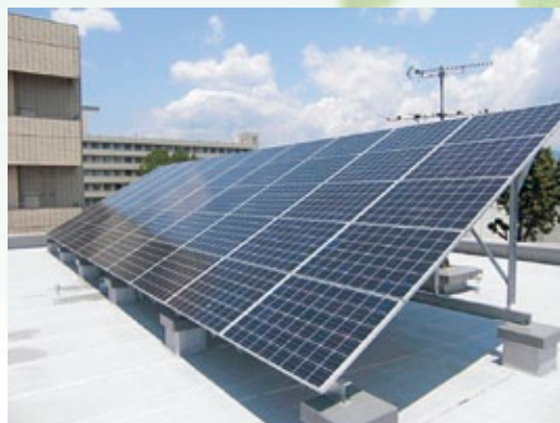
太陽光発電設備
