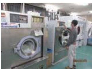
洗濯室/洗濯機
