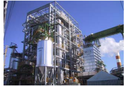
特種東海製紙(株)島田工場の木質バイオマス混焼発電所(島田市向島)
