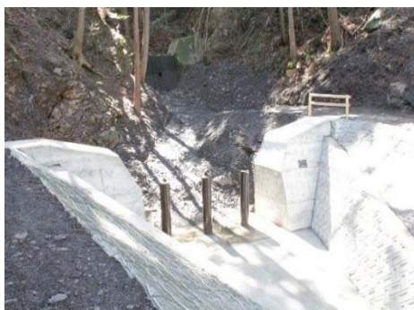
流木を捕捉する治山ダム（浜松市天竜区春野町杉）
