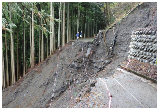
林道明ヶ島線の被災状況 (島田市川根町家山)
