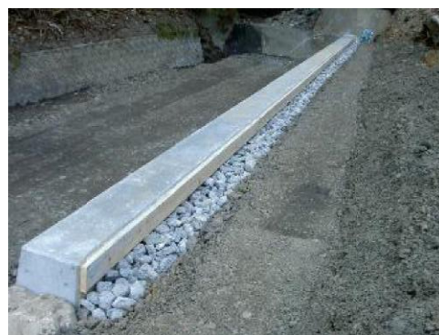
【護岸工】 残存型枠
