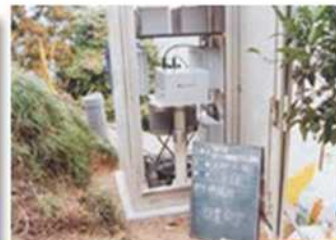
観測機器の設置状況
