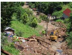
浜松市浜名区引佐町洪川 土砂流出状況
