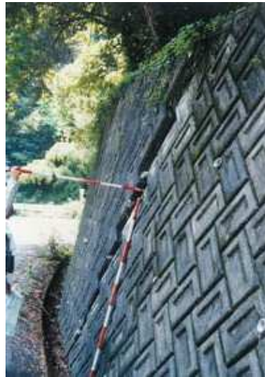
ブロック積に発生したクラック
