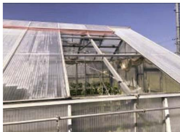
温室アクリル板の破損（温室メロン）
