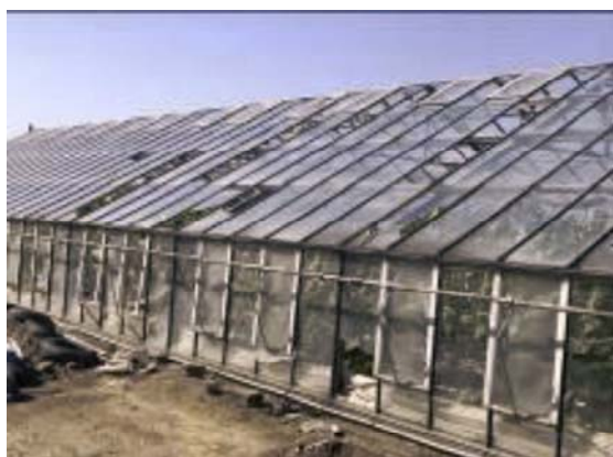
温室ガラスの破損（温室メロン）
