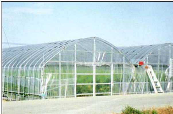
パイプハウス（被害が大きかった）
