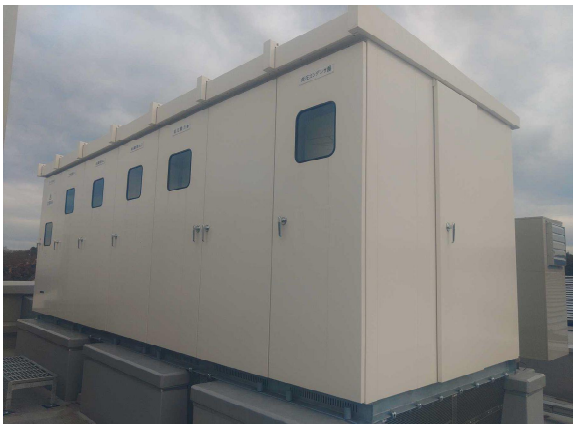
屋外キュービクル
