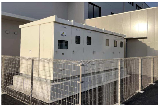
屋外キュービクル
