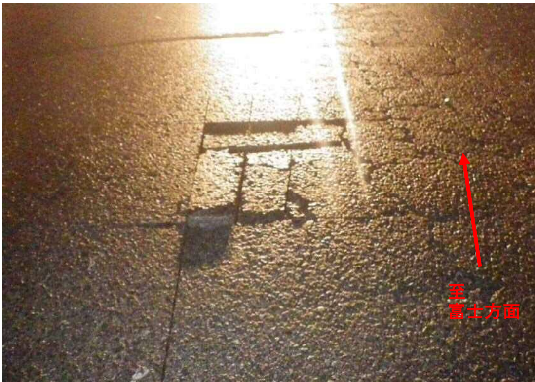
舗装版が抜き出た状況
