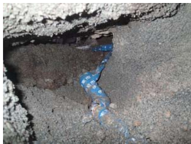
損傷部(継ぎ手部分)
