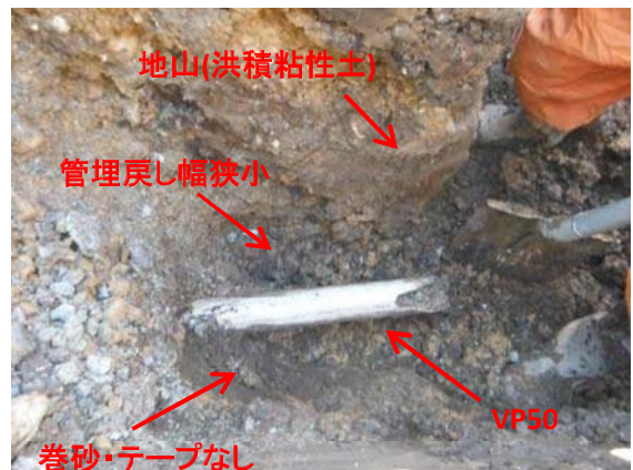
写真6:管の破損状況(南歩道側)
