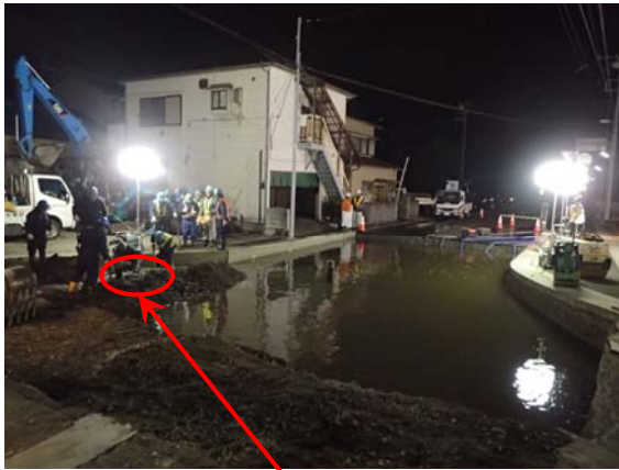
水道管破損箇所
