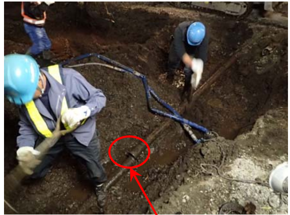
水道管(接合部)破損状況
