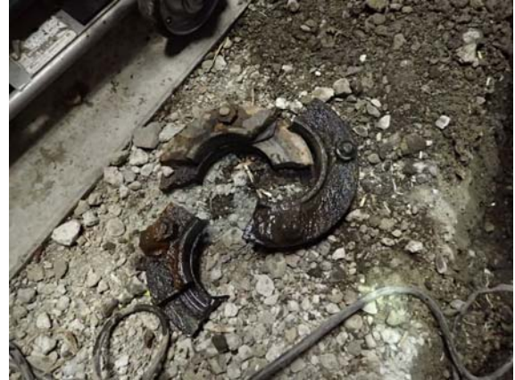
水道管(接合部)破損状況
