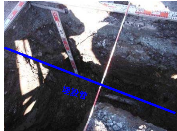
写真8:管の破損状況(全景)
