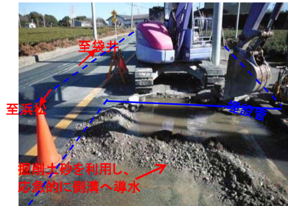
写真2: 管破損・漏水発生
