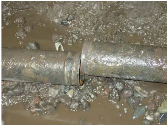
水道管(接合部)破損状況
