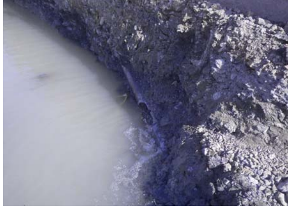
水道管破損状況
