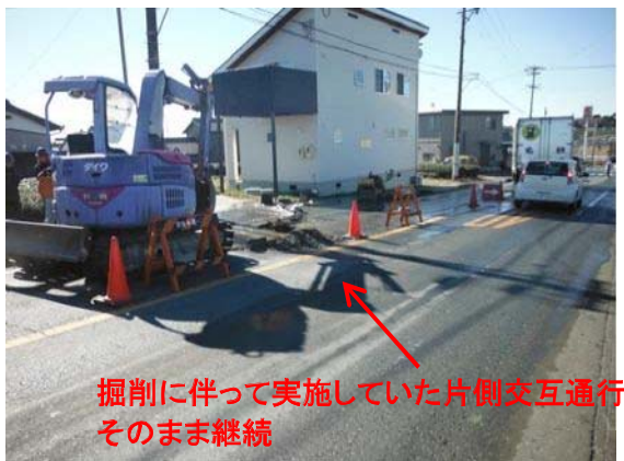
写真3: 事故状況全景
