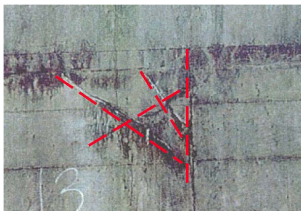
写真 2.1 ブロック化したひび割れの例 11)
