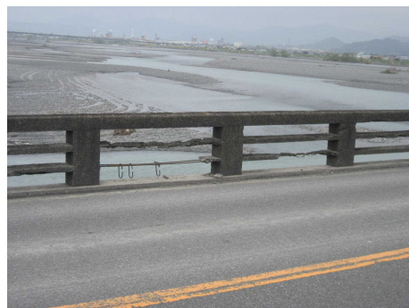
写真1 高欄部材の欠損
