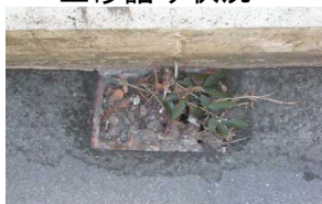
土砂詰り状況
