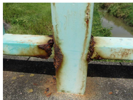
写真2 高欄の著しい腐食
