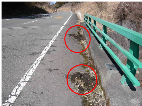
排水柵の土砂詰り（清掃前）
