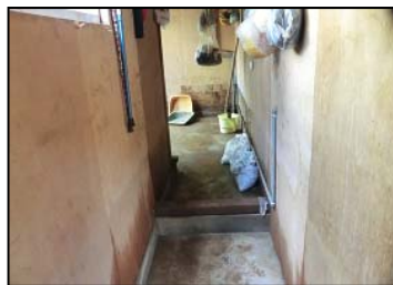
④須原地区の浸水被害
