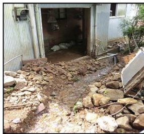
②須原地区の浸水被害
