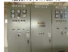
陸電装置(周波数・電圧変換)
