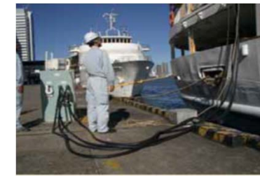
船舶への陸上電力供給
