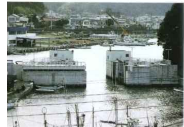
船溜前面に設置した水門 (西伊豆町)
