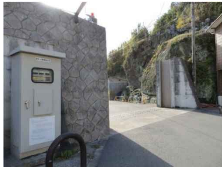
陸閘(電動式)の整備 (南伊豆町)
