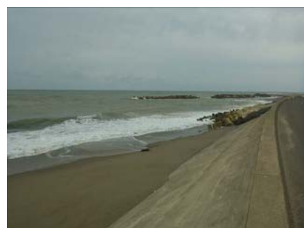
浜松五島海岸の侵食状況(H25.4)
