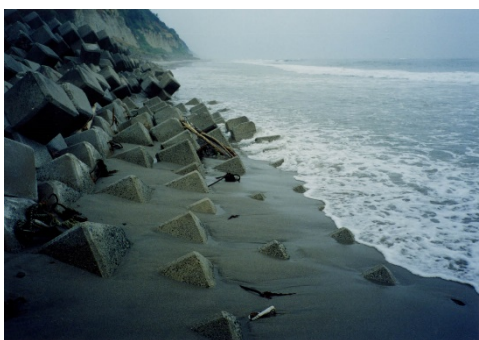
豊橋海岸西赤沢の侵食状況(H13.12)
