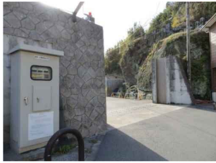
陸閘(電動式)の整備 (南伊豆町)
