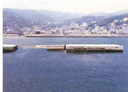
1982年台風10号による 防波堤被害が生じた熱海港（熱海市）
