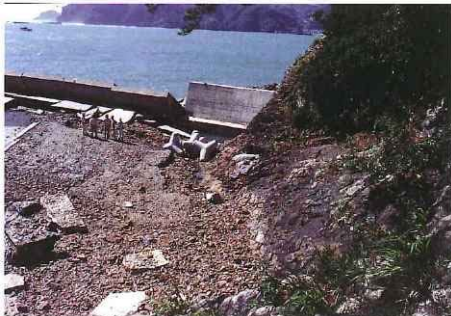
1985年6号台風による波浪被害 （南伊豆町）
