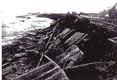
富士海岸三四軒屋地先 台風26号 昭和41年9月
