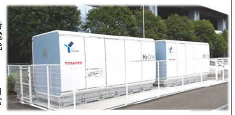
(自立型水素燃料電池システム)
