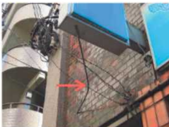
振れ止め棒が変形した状態
