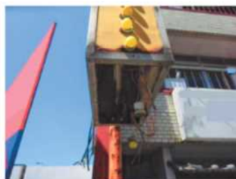
側板底面が欠損した状態
