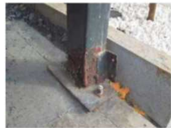
支柱根元の腐食が進行した状態
