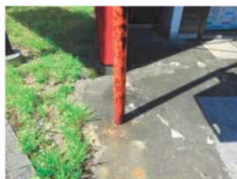
支柱の腐食が進行した状態
