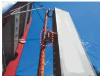
支柱・広告板接合部の腐食・隙間
