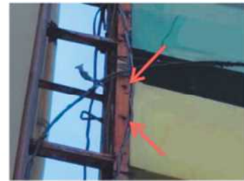
ボルトのゆるみや欠落した状態
