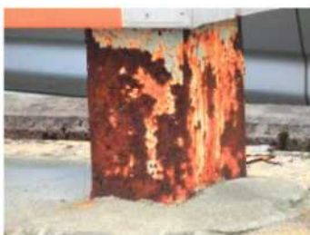
支柱根元の腐食が進行した状態
