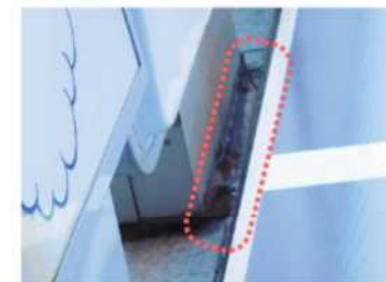
コーキングが劣化した状態
