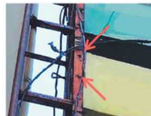
ボルトのゆるみや欠落した状態
