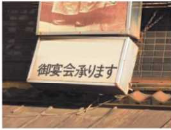
屋外広告物本体の傾き
