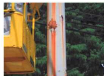
支柱の腐食が進行した状態
