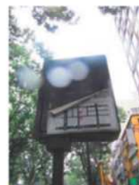
シート材がはがれかかった状態
