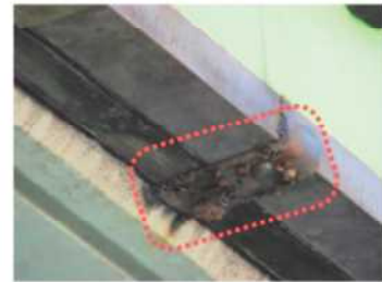
金具が劣化した状態
