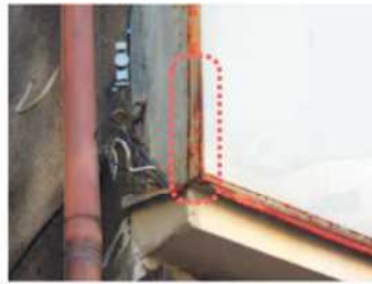
側板・表示面板押さえの変形（ゆがみ、隙間）
