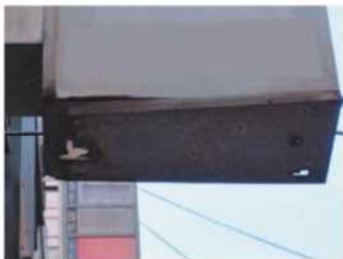
側板底面が腐食、破損、変形した状態
