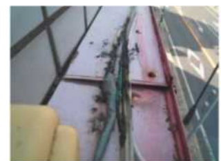
配線が劣化し、ショートした状態
