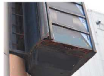
側板底面が腐食、破損した状態
