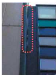
屋外広告物・壁面の隙間、壁面のひび、はらみ、浮き
