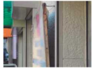
壁面との間に隙間が生じた状態
