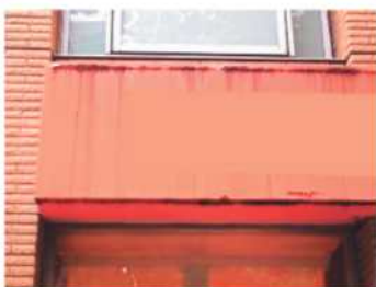
側板の腐食が進行した状態
