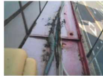
配線が劣化し、ショートした状態
