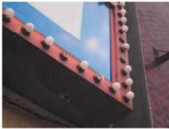
ランプ球が破損した状態
