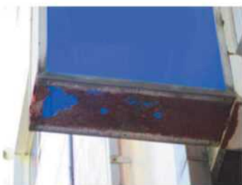
側板底面が腐食、破損した状態
