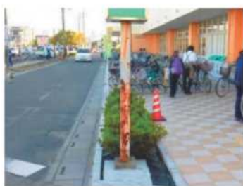
支柱の腐食が進行した状態
