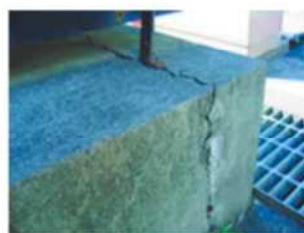
基礎にクラックが入った状態
