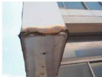
側板の腐食が進行した状態
