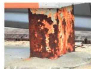
支柱根元の腐食が進行した状態
