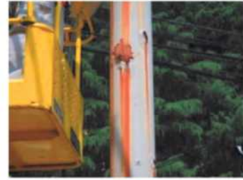
その他（支柱の腐食など）
