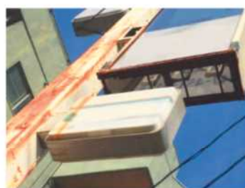
支柱にさびが発生した状態
