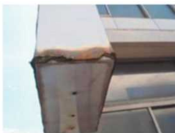
広告板底部の腐食
