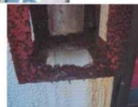
支持部が腐食していた看板の例
