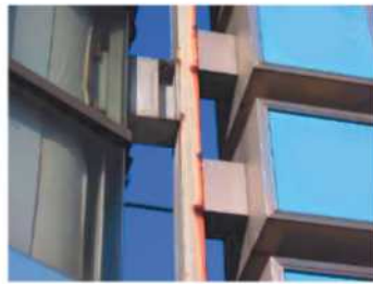
支持部が腐食した状態
