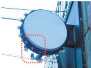
照明器具の傾き、外れ
