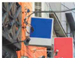
上部構造全体が傾斜した状態
