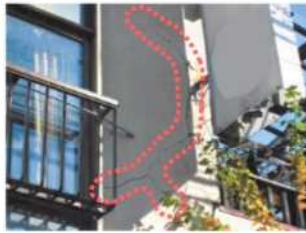
壁面にひびが生じた状態
