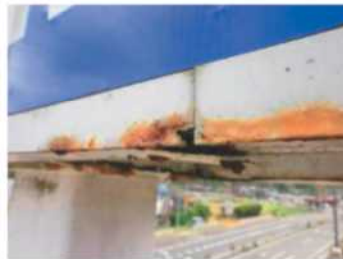
その他（塗装剥離、腐食など）
