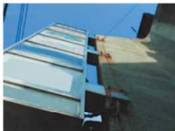
壁面に取付部の汚ダレが見られる状態
