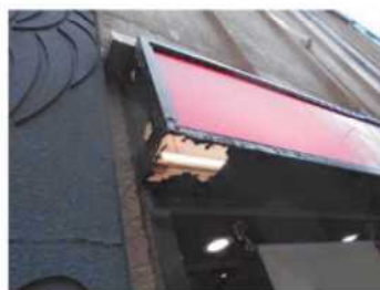
側板底面の腐食が進行した状態
