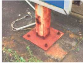
支柱根元の腐食、支柱と基礎部分・根巻きに生じた隙間、支柱ぐらつき
