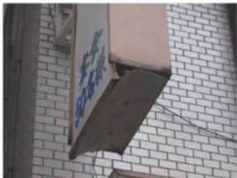
その他 (塗装剥離、腐食など)
