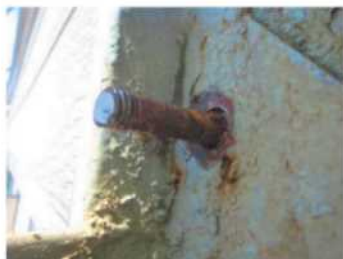
アンカーボルトのさびが進行し、ネジ山が欠損した状態
