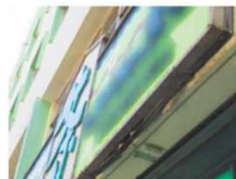
側板底面が破損した状態
