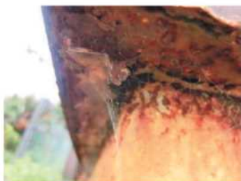
支柱・広告板接合部の腐食が進行した状態
