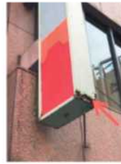
広告板底部の腐食が進行した状態
