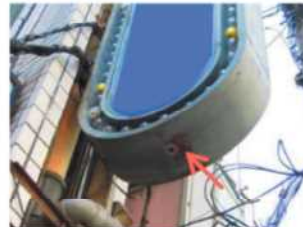
水抜き孔が詰まった状態
