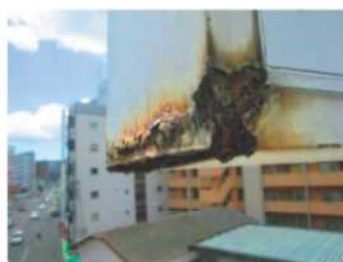
側板の腐食が進行した状態
