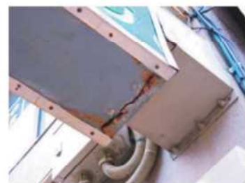
側板底面が破損した状態
