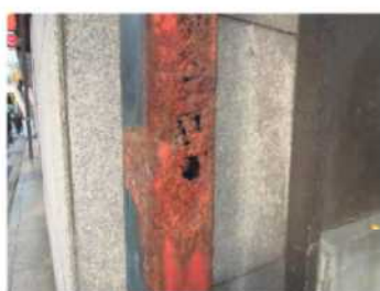
支柱の腐食が進行した状態
