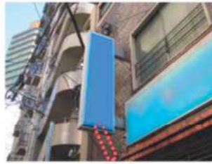
振れ止め棒が変形した状態
