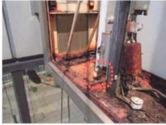
蛍光灯ホルダーが破損した状態
