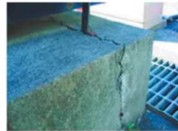
基礎にクラックが入った状態
