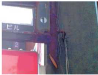
支持部が腐食した状態
