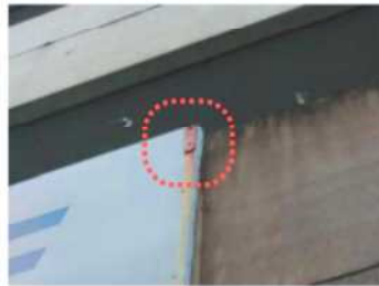
金具が劣化した状態
