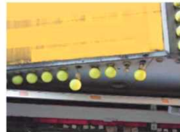
照明器具の傾き、外れ
