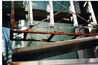
↑看板底部の脱落
