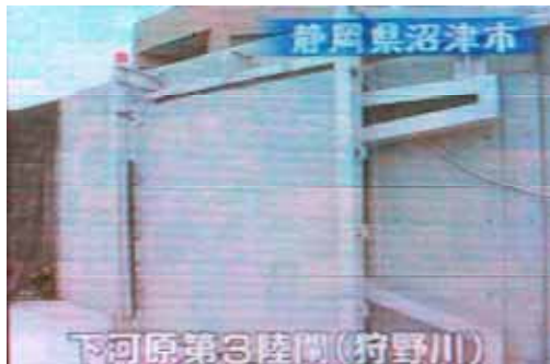
地震発生により水門を閉鎖
