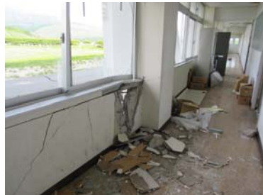
写真. 1号館1階廊下の損傷状況.
