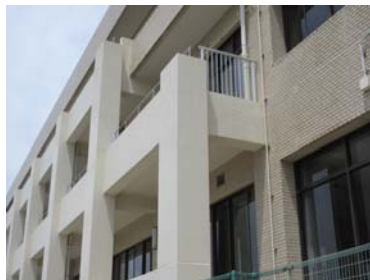
写真. 外付けフレームつなぎ梁:ひび割れ発生;補強効果は発揮された.
