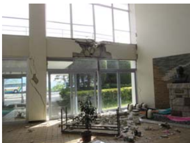
写真. 玄関口の湾曲部のはり損傷.
