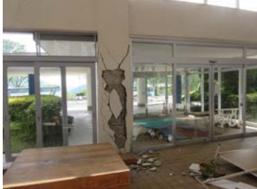
写真. 1号館玄関口の損傷状況.
