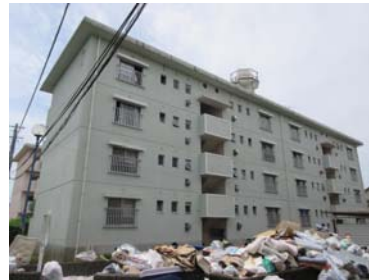
写真. 壁式R/C造：開口部きれつ不認.
