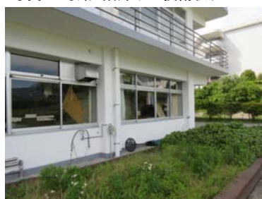
写真. 1号館1階補強構面柱の損傷.
