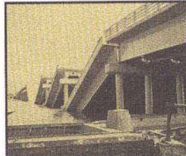
地割れで寸断した道路（1983年日本海中部地震M7.7、秋田県若美町五明光橋）
