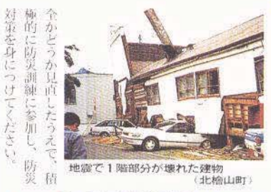
地震で1階部分が壊れた建物 (北檜山町)
