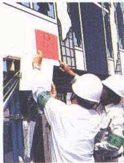
被災建築物の応急危険度判定訓練
