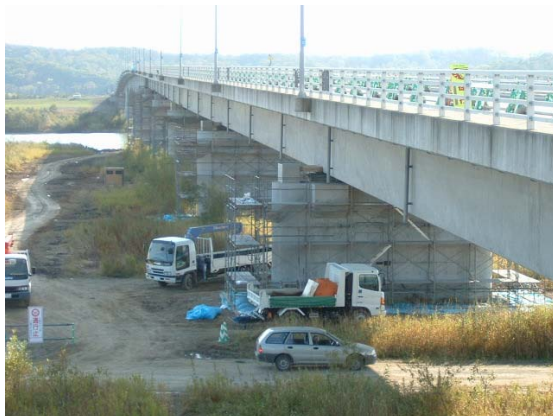
国道 336 号十勝河口橋 (左岸上部工が 35cm 横ずれした。)
