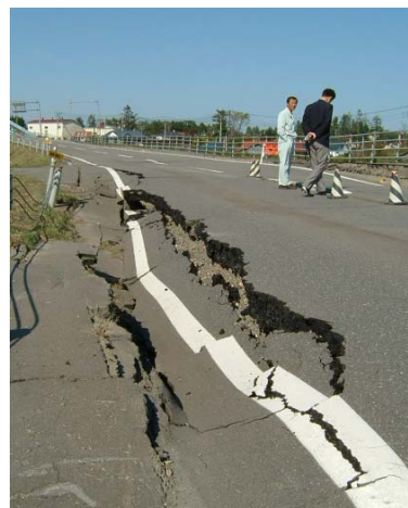
主要道道「帯広浦幌線」の被害 (豊頃町)
