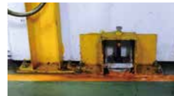
第一次対策から第三次対策にかけて順次強化されてきた固定器具 (ケミカルアンカー固定)
