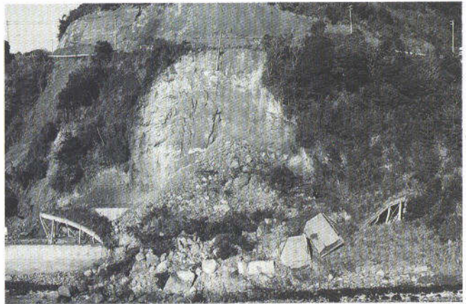
写真6 昭和53年（1978年）の伊豆大島近海地震による急傾斜地の崩壊 （東伊豆町：共同通信社提供）
