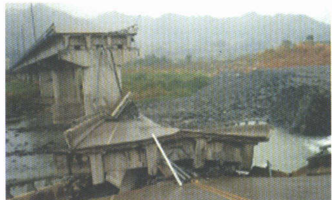
写真2 台湾集集(チーチー)地震の活断層によって倒壊した橋（撮影 小澤邦雄）
