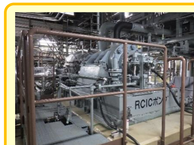
高圧注水設備 (タービン駆動)
