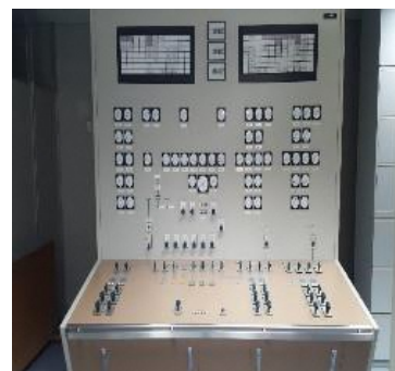
ガスタービン発電機操作盤
