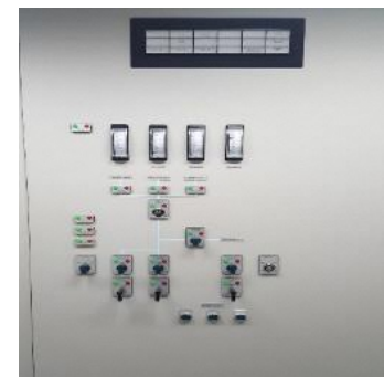
緊急時海水取水設備操作盤
