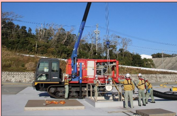
可搬型注水設備操作訓練
