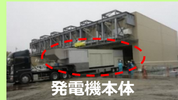
ガスタービン発電機
