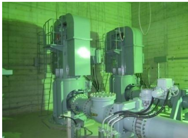
緊急時海水取水ポンプ
