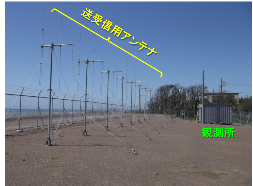
VHFレーダー設備(御前埼灯台付近)
