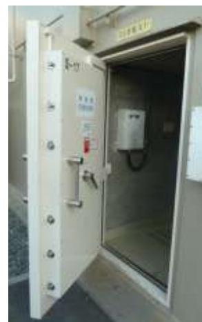
防水構造の扉(開の状態)
