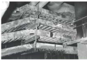
米国の火災防護規制強化のきっかけとなったBrowns Ferry 1号機のケーブル火災(1975年3月22日発生)
