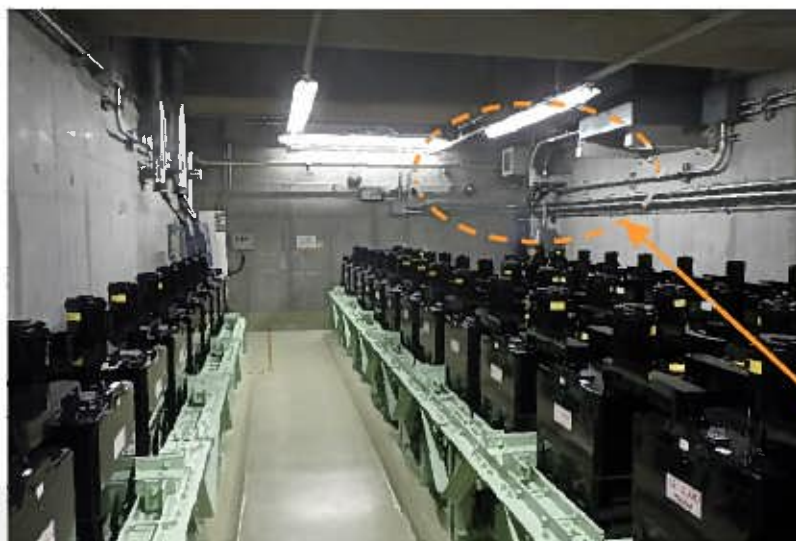
蓄電池室及び 空調吸い込み口例
