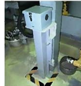
漏えい検知器
