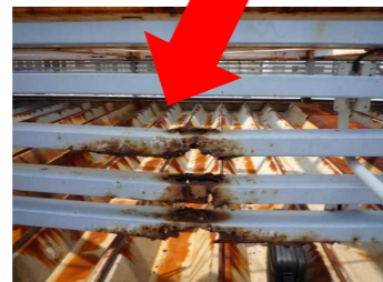
↑目隠しルーバーのサビ・腐食。
