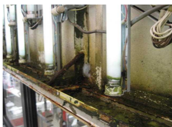
↑内照式看板内部の腐食、部材の腐食器具の劣化による出火の恐れも。
