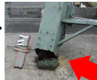
折れた柱の根元。点検口のボルト穴からサビが入り腐食して、鉄骨が破断した。
