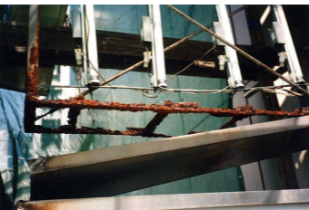
↑看板底部の脱落
