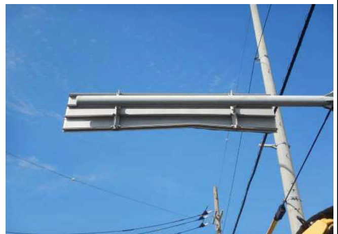
看板損傷状況（裏面）
