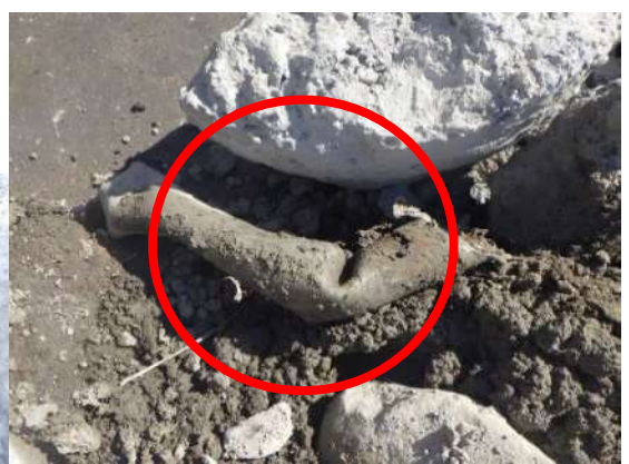
破損した下水管
