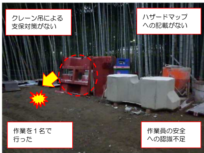
安全対策前の現場状況
