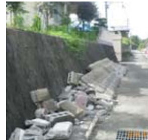
熊本地震での被害状況
