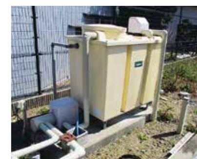
敷地内にある緊急時の井戸
