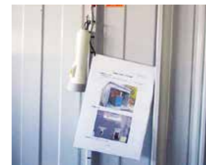
発電機のマニュアルと夜間操作用の懐中電灯
