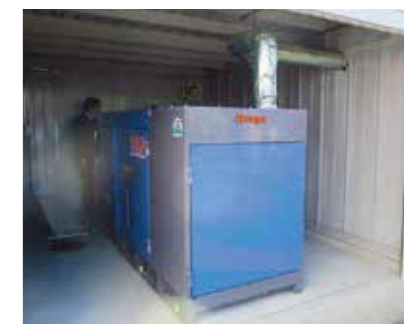
150kwのディーゼル発電機
